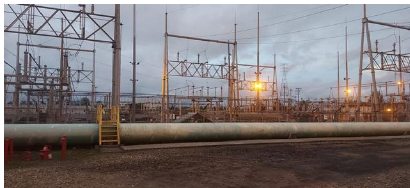
Gambar 12. Sistem Penyaluran Energi Listrik PT. Freeport Indonesia (Portsite)
