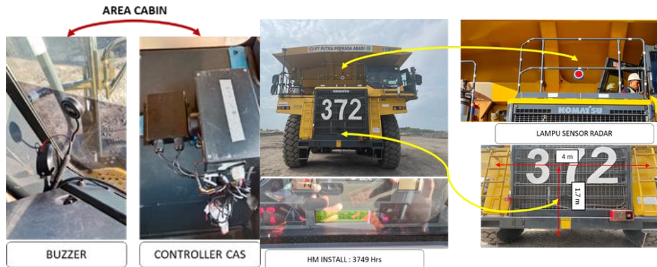
Gambar 1 Lokasi Pemasangan Collision Avoidance Systems (CAS)
